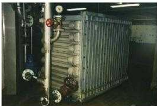
Factory picture: ARA Örebro, Schweden
